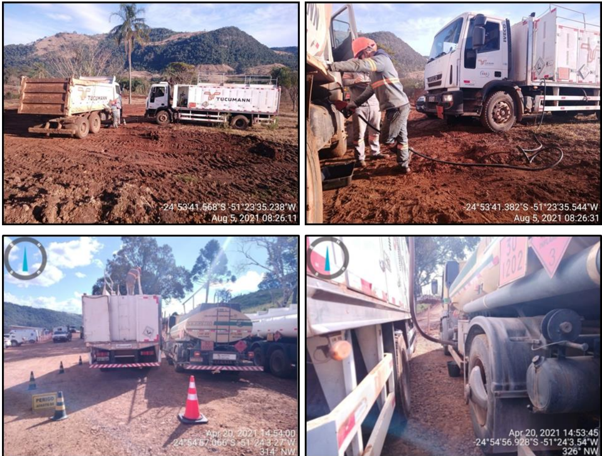
Figura 241 - Abastecimentos realizados por caminhão comboio nas frentes de serviço. Com o devido isolamento do local, utilização de dispositivos de contenção (balde e bacia) e uso dos EPIs necessários (máscara e luva nitrílica).
