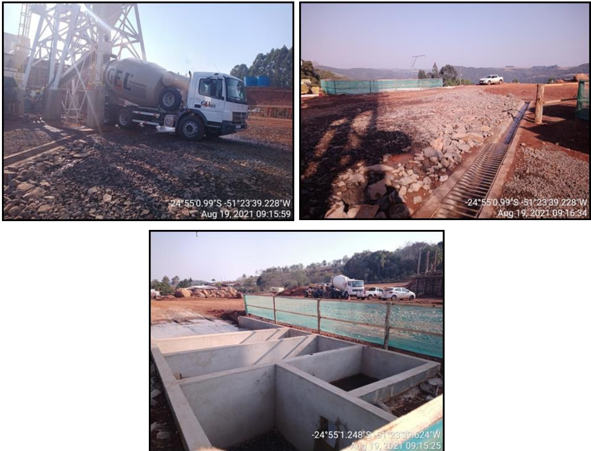
Figura 252 - Rampa de lavagem de concreto dotada de sistema de drenagem e sistema de decantação.
