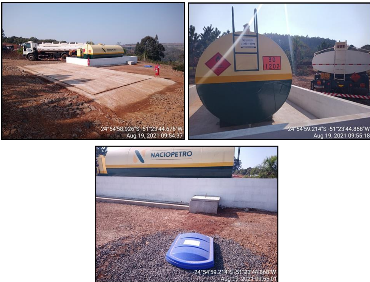
Figura 240 - Tanque de abastecimento de óleo Diesel, equipado de sistema de contenção, drenagem e caixa SAO (separadora de água e óleo), da PCH Confluência.
