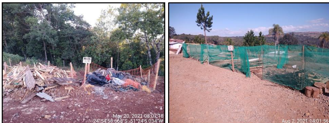
Figura 231 - Baias do canteiro industrial da PCH Confluência.
