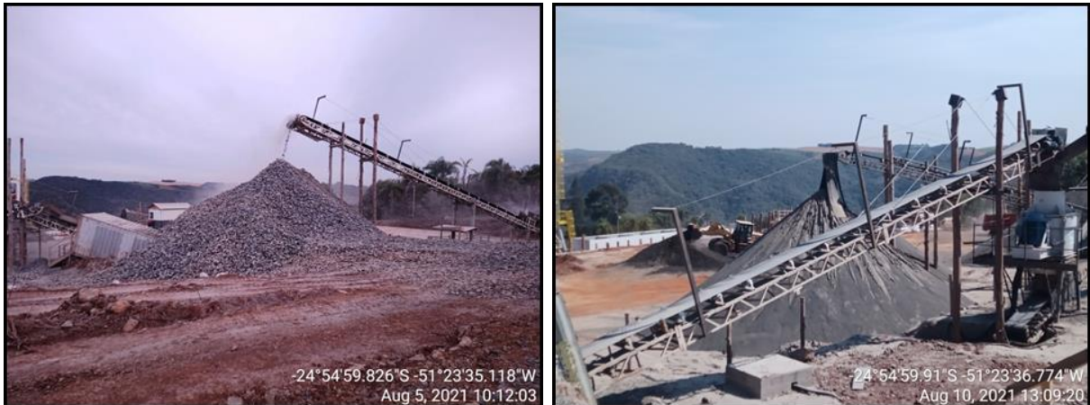
Figura 259 - Controle de material particulado em suspensão na central de britagem - aspersores de água e barreiras físicas.
