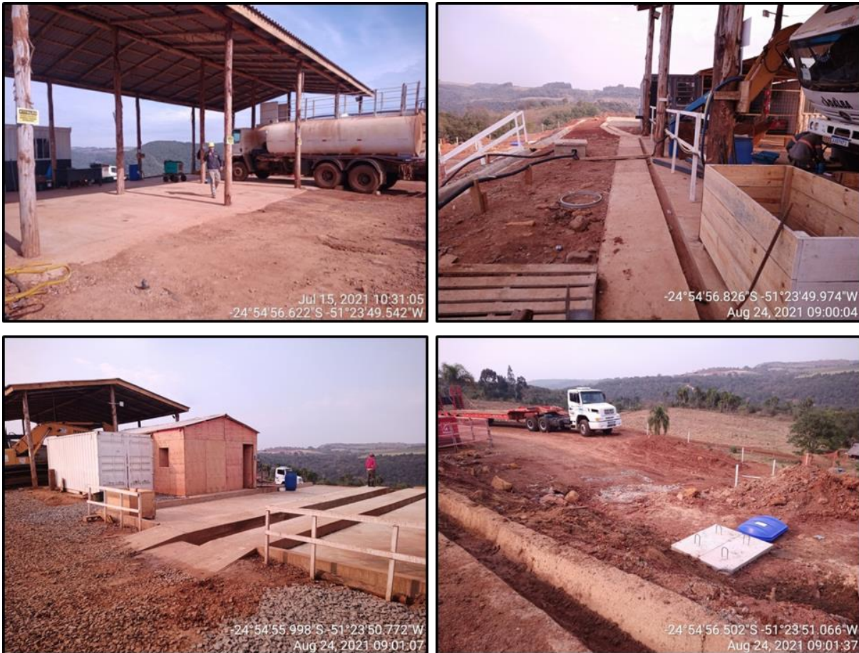
Figura 251 - Sistema de tratamento de efluentes da oficina e rampa de lavagem. Composta por sistema de drenagem, decantador e caixa SAO.
