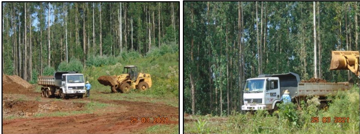
Figura 186 - Extração de material em jazida particular próxima ao canteiro de obras da PCH Confluência.
