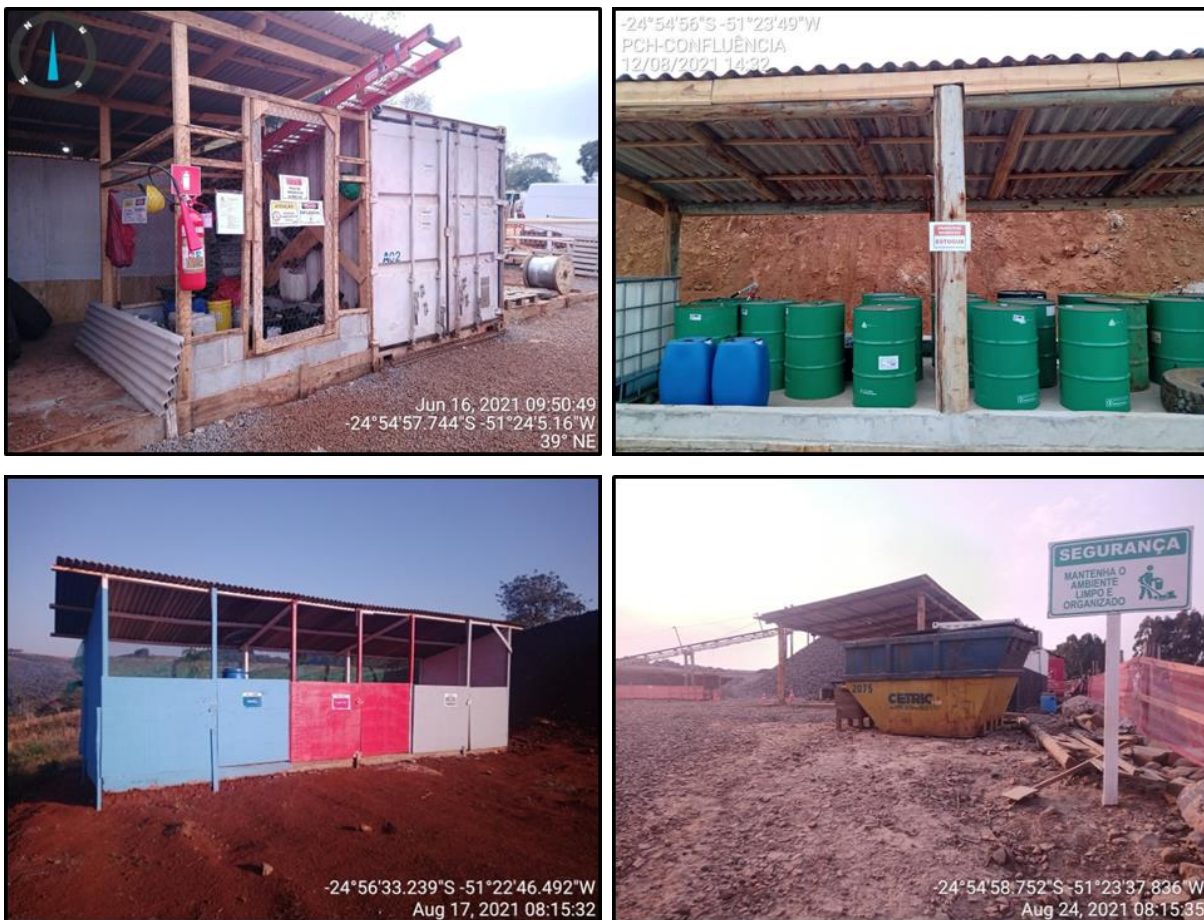
Figura 235 - Central de produtos e resíduos classe I; central de resíduos classe II, contendo baias de plástico, papel e não reciclável; e caçamba para armazenamento temporário de resíduos classe I.
