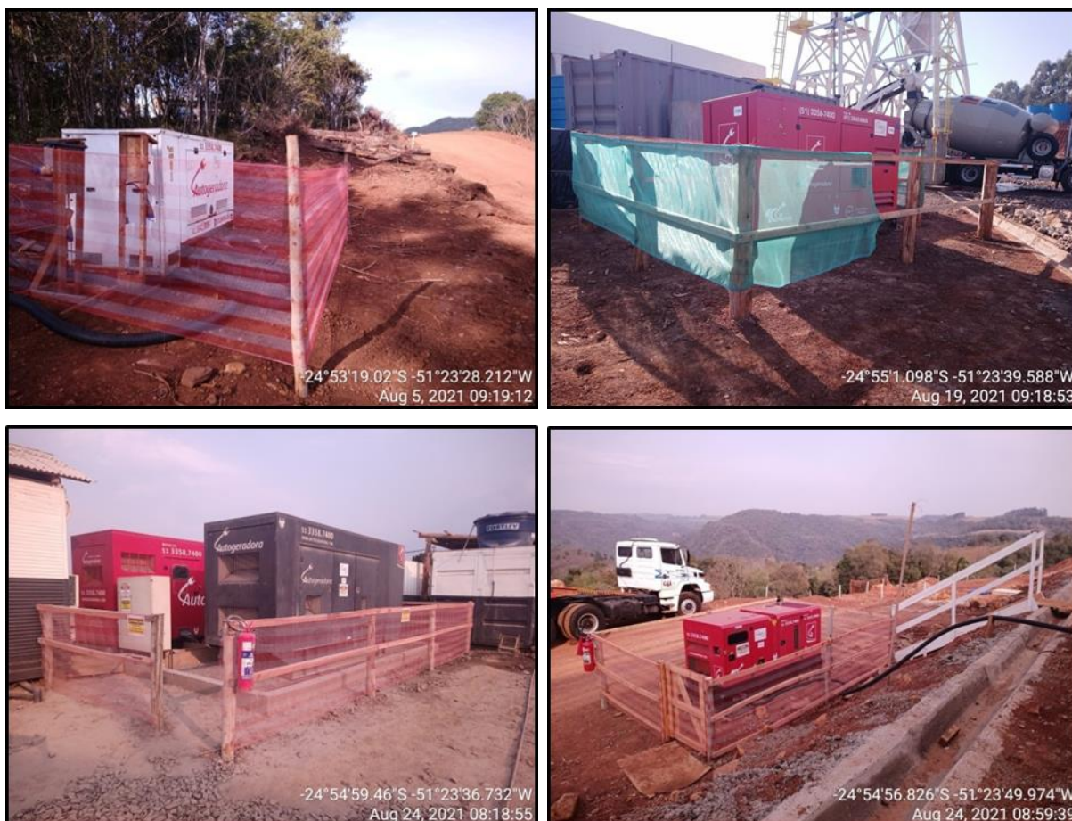
Figura 253 - Exemplos de geradores utilizados no canteiro de obras da PCH Confluência. Com o devido isolamento de segurança e com bacia de contenção interna.
