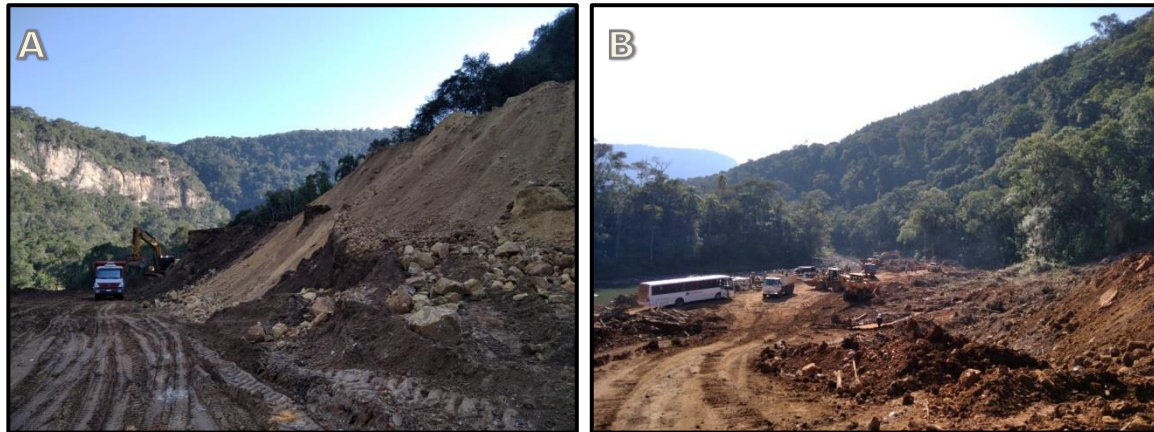
Figura 10 – Denudação do solo nas atividades de corte e aterro e abertura de vias de acesso, no barramento (A) e na casa de força (B).
