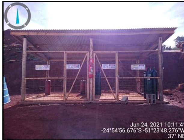
Figura 239 - Central de cilindros.
