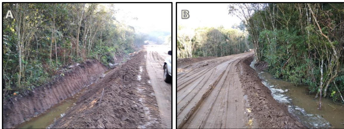
Figura 11 – Sistema de drenagem temporário na lateral da via de acesso.
