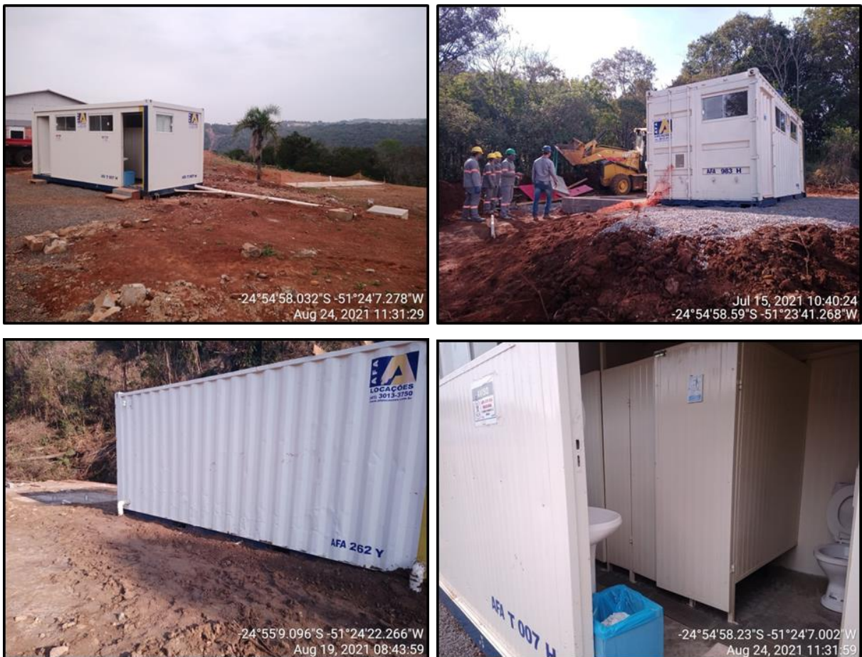
Figura 250 - Unidades sanitárias fixas, tipo container, dotados de ETE, disponibilizados próximos às frentes de serviços a partir do mês de junho/2021, na PCH Confluência.
