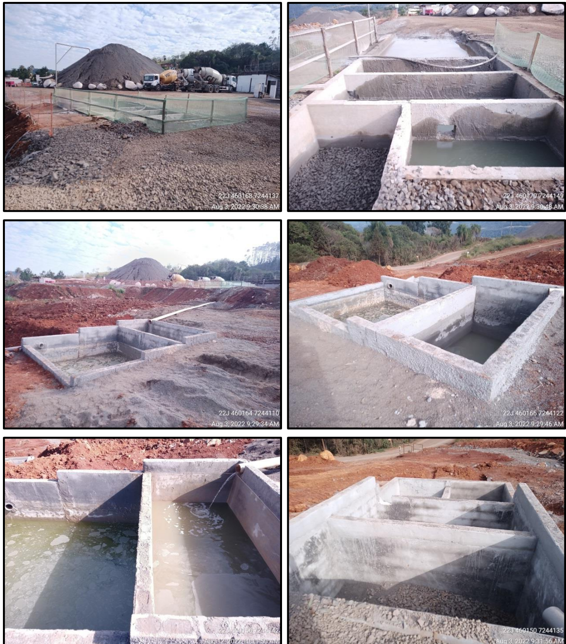
Figura 170 – Bate-lastro de concreto dotado de sistema de drenagem composto por decantador do bate-lastro, filtro 1º e filtro 2º com aproximadamente 50 m 3 cada.
