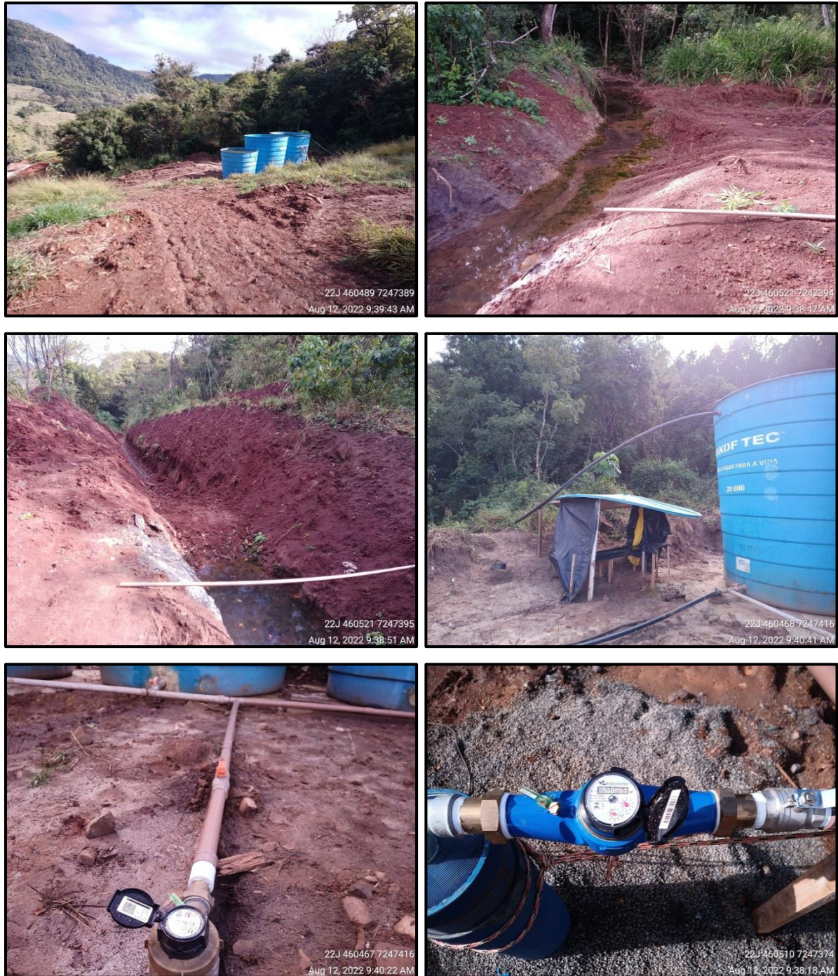
Figura 183 – Captação superficial em corpo hídrico sob declaração de uso independente de outorga 15166/2021/DUIO-GOUT, protocolo nº 18.476.163-7.
