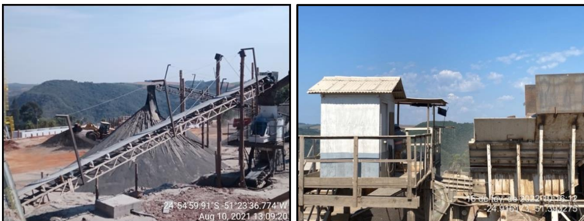
Figura 182 - Controle de material particulado em suspensão na central de britagem - aspersores de água e barreiras físicas.
