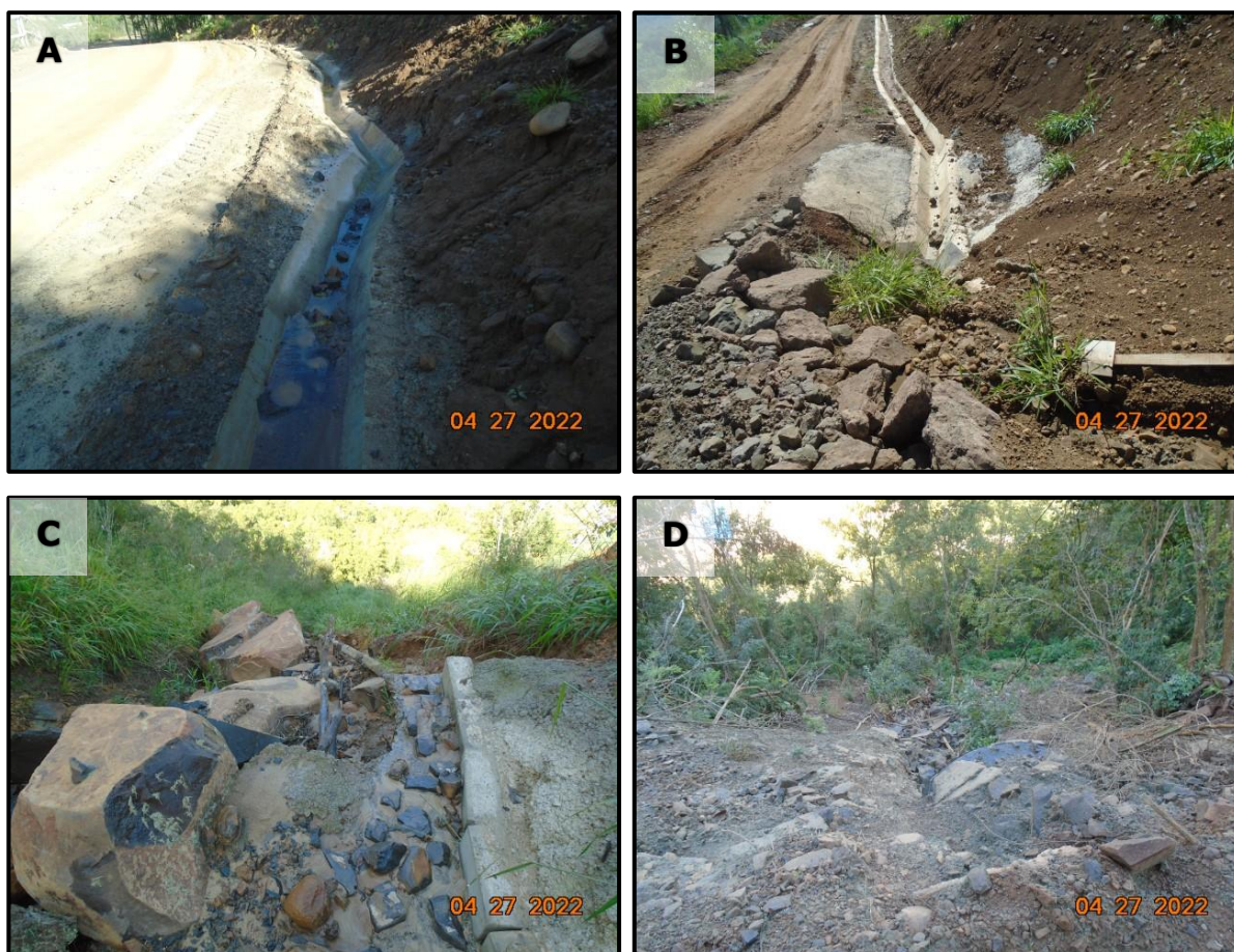
Figura 12 – Registros fotográficos relacionados aos sistemas de drenagem, situação identificada em abril de 2022.
