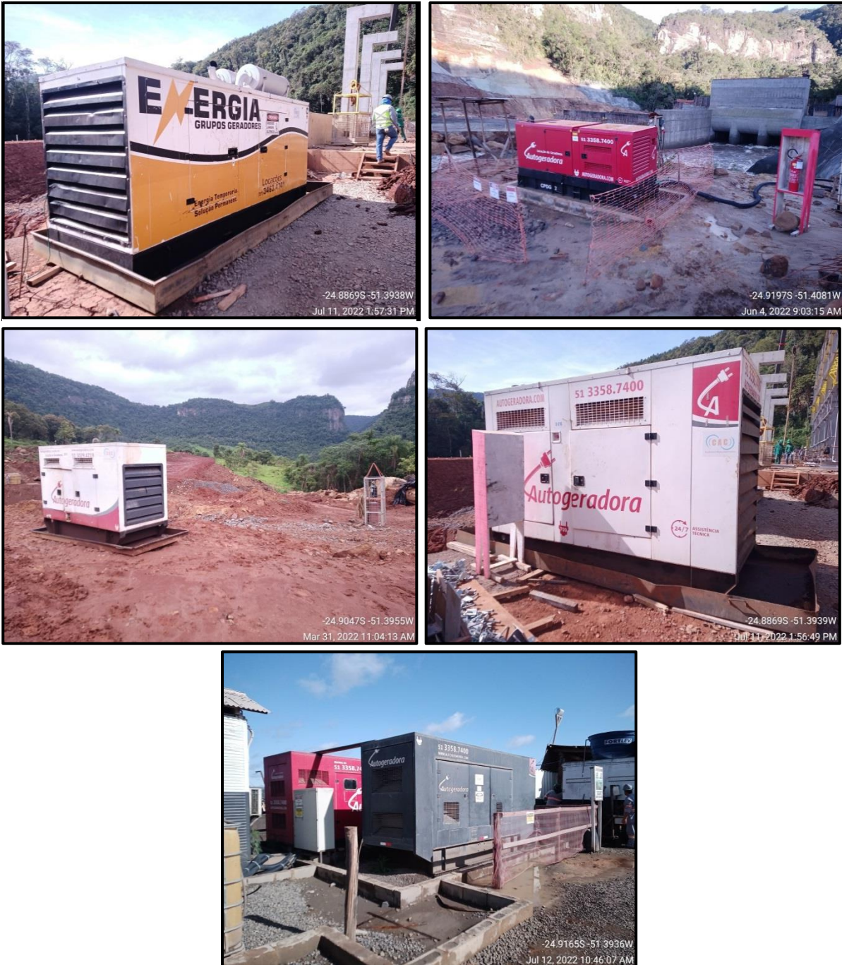
Figura 174 - Exemplos de geradores utilizados na PCH Confluência com o devido isolamento de segurança e com bacia de contenção interna e externa.
