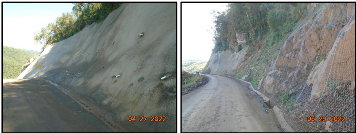
Figura 6 – Talude de corte da via de acesso ao barramento. Vistoria realizada em 27/04/2022 e em 29/06/2022.
