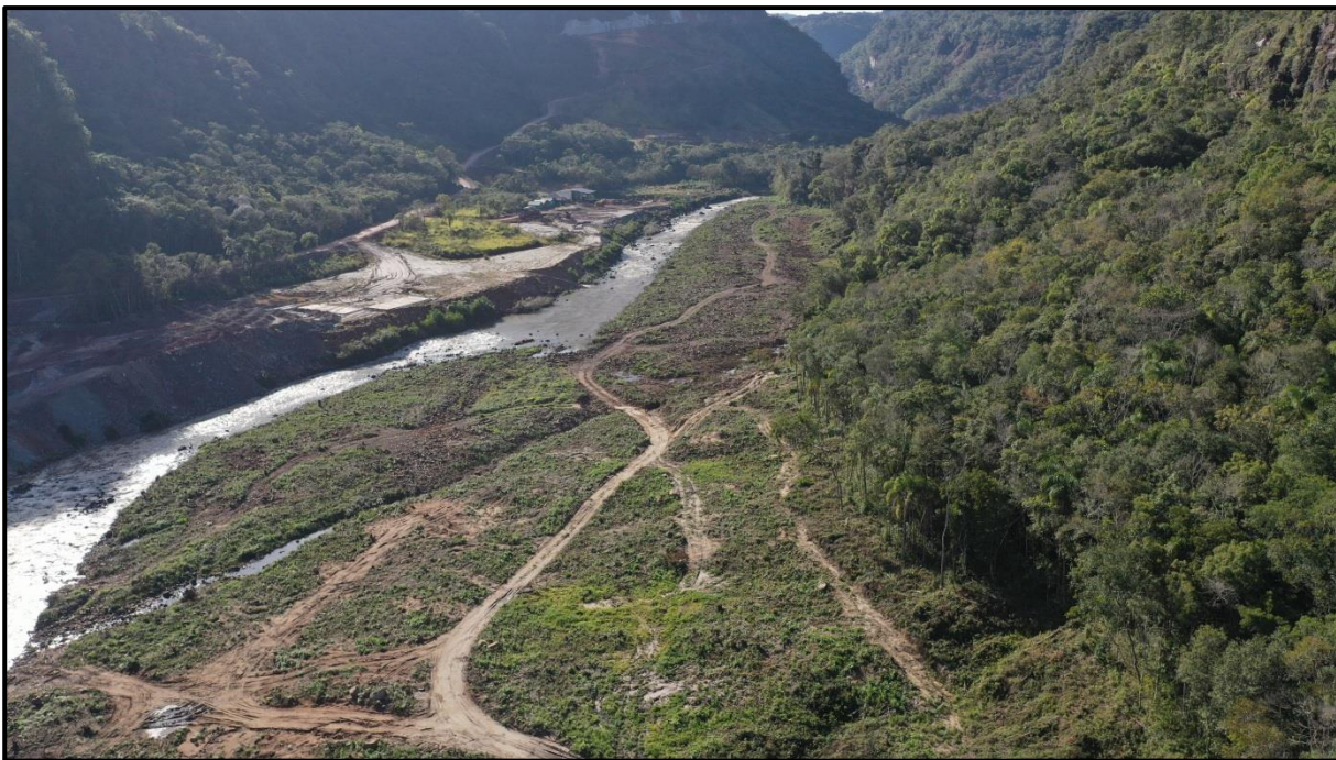
Figura 35 – Visão geral da supressão vegetal e acessos de serviço para retirada de madeira da área do reservatório (sentido barramento->montante) em julho/2022, durante a fase de implantação da PCH Confluência.
