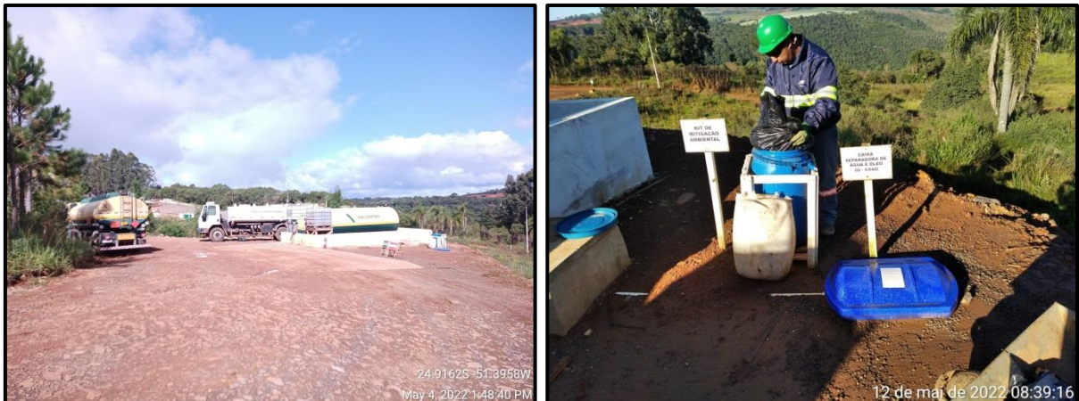
Figura 173 - Tanque de abastecimento de óleo Diesel, equipado de sistema de contenção, drenagem e caixa SAO (separadora de água e óleo), da PCH Confluência.
