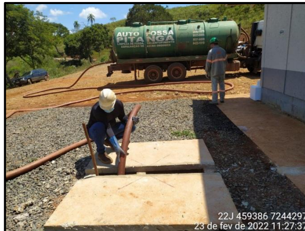
Figura 177 - Caixa de gordura de tratamento primário do efluente do refeitório oriundo da lavagem de pratos e talhares.
