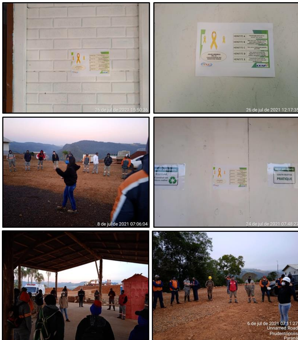
Figura 110 – Cartazes informativos e diálogos diários de segurança acerca das Hepatites Virais no canteiro de obras da PCH Confluência.
