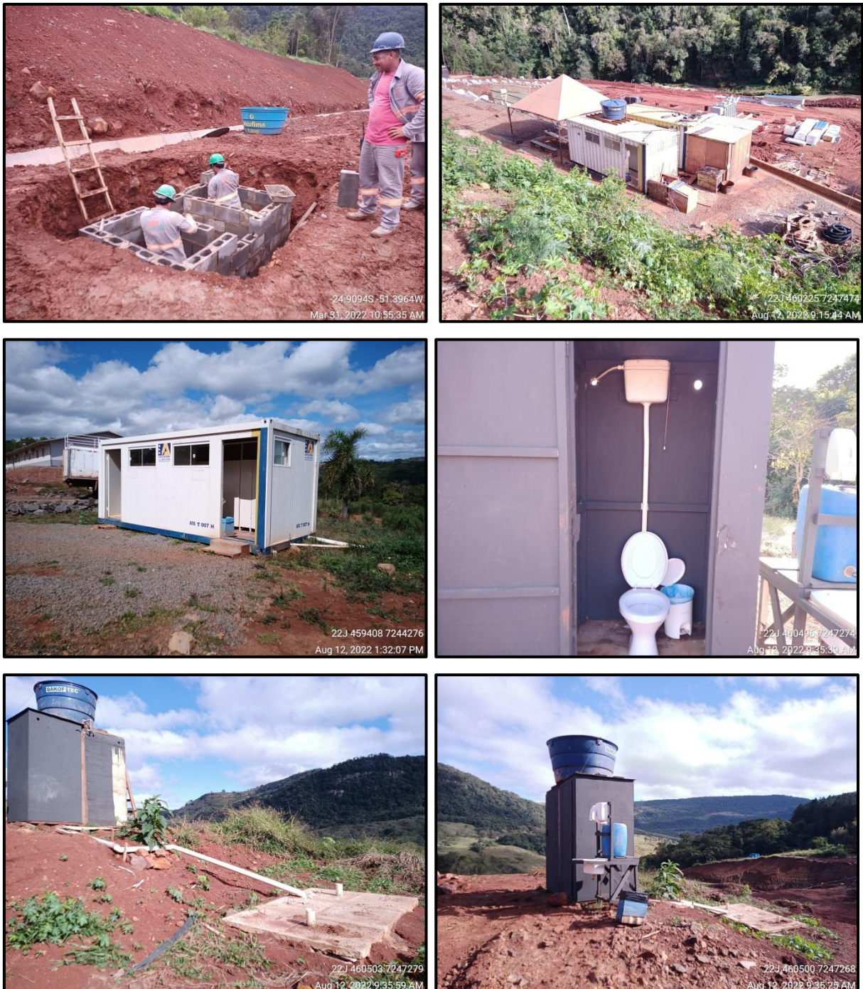
Figura 169 – Exemplos de unidades sanitárias fixas, tipo container, dotadas de ETE 1ª, 2ª e sumidouro próximas às frentes de serviços na PCH Confluência.
