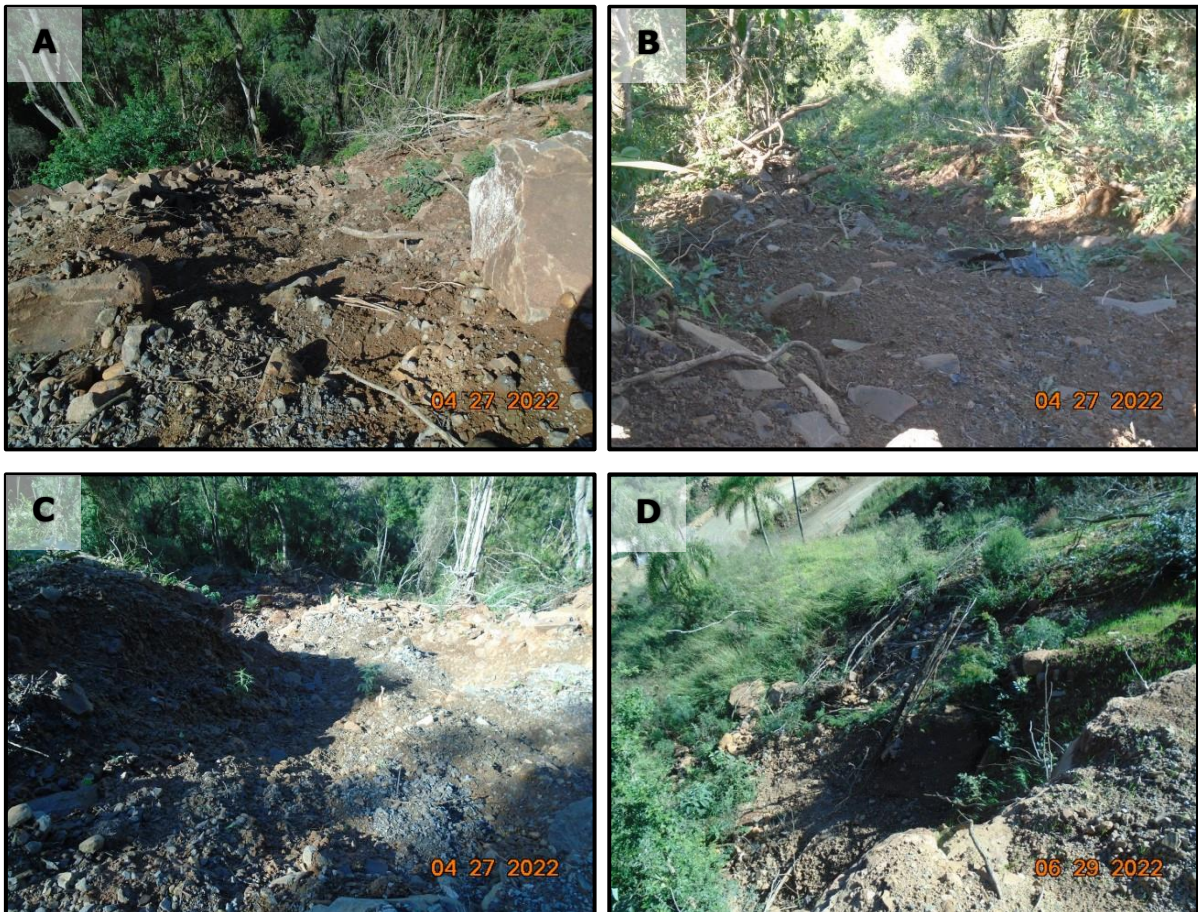
Figura 9 – Processos erosivos registrados no talude de aterro da via de acesso ao barramento. Fotos tiradas nas vistorias realizadas em 27/04/2022 e em 29/06/2022.
