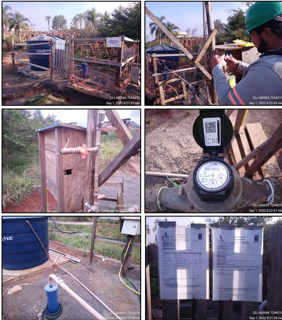
Figura 128 – Captação de água subterrânea para abastecimento de bebedouros do canteiro. Sistema de tratamento com adição e controle de cloro diário da PCH Confluência.
