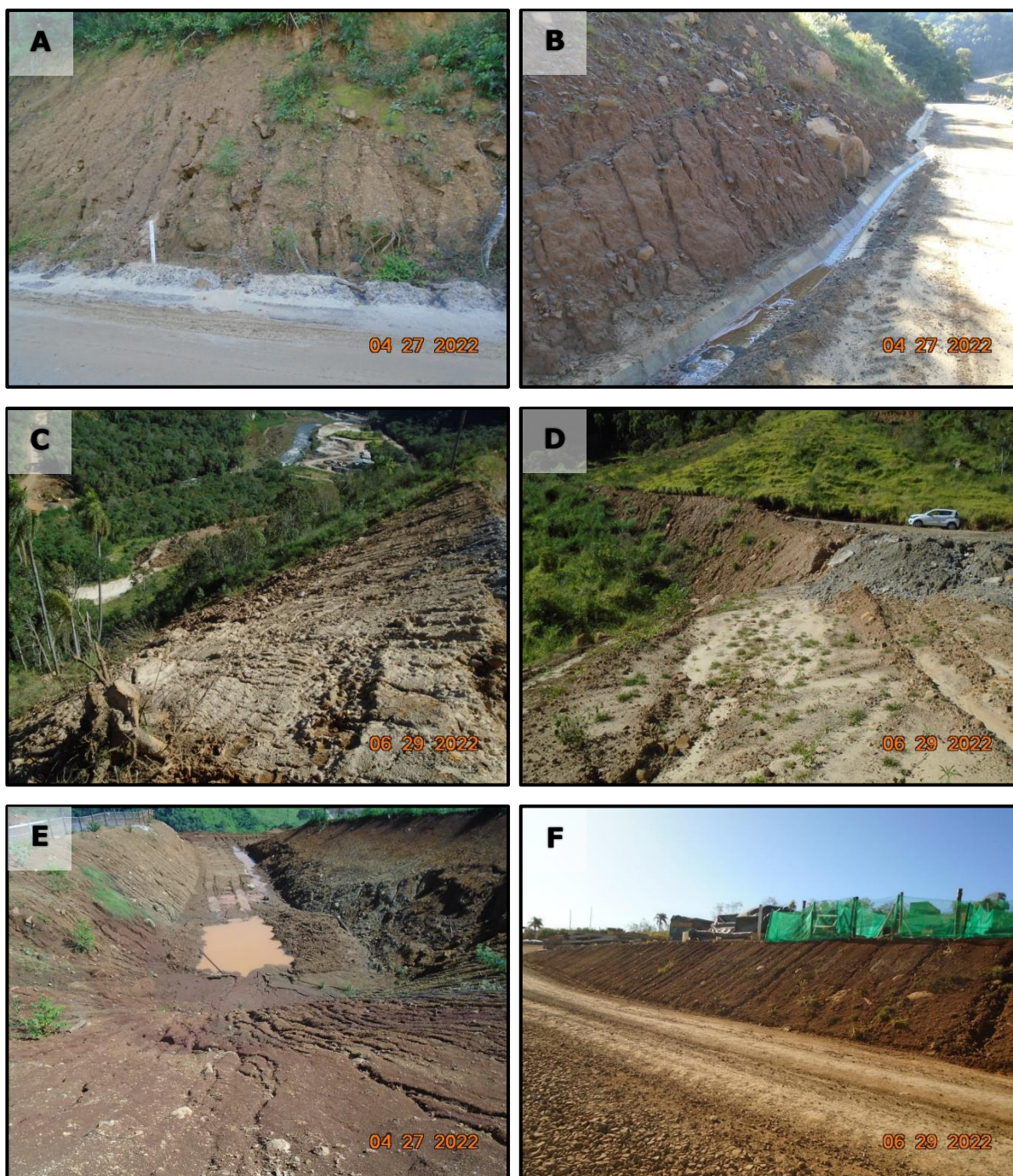
Figura 8 – Sulcos erosivos em taludes identificados no primeiro semestre de 2022.
