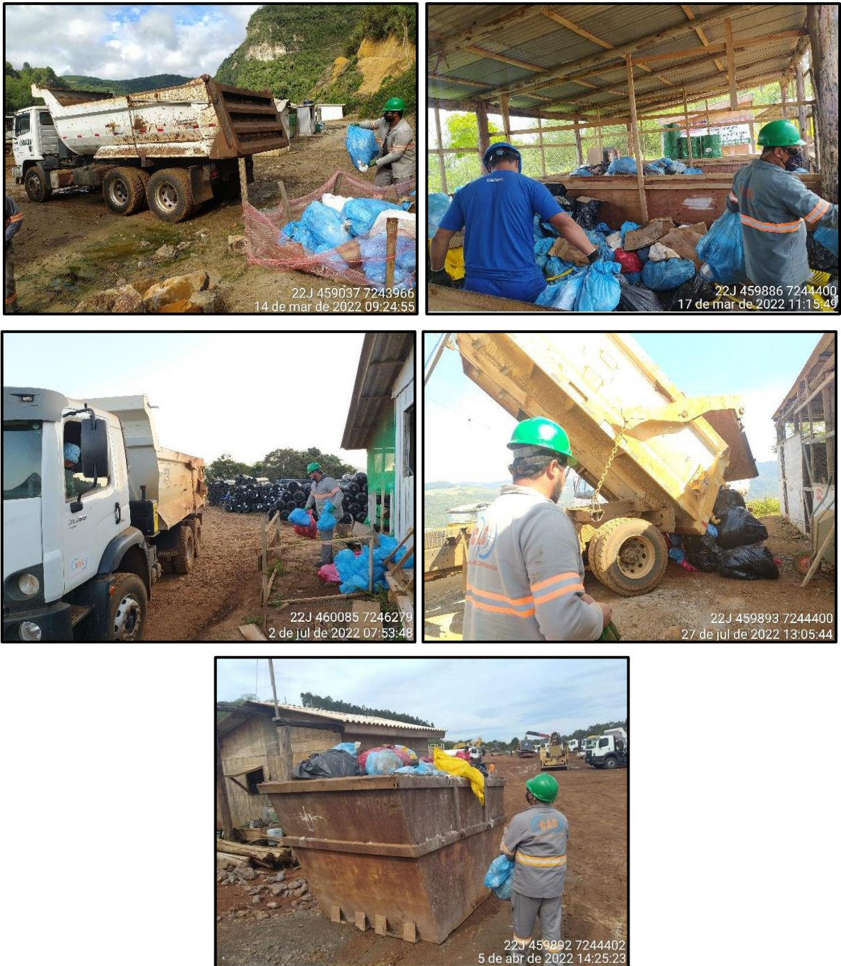
Figura 156 - Recolhimento e transporte interno de resíduos gerais no canteiro do PCH Confluência.
