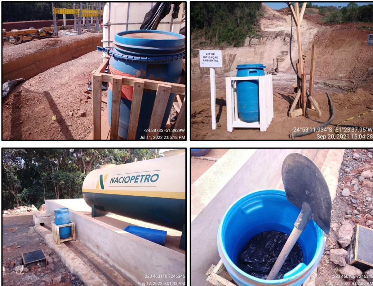
Figura 176 - Exemplos de alguns dos kits de mitigação disponibilizados nas frentes de serviço e no canteiro da PCH Confluência. Em geral, os kits contêm serragem, pá antifáisca, luva nitrílica e bacia de contenção.
