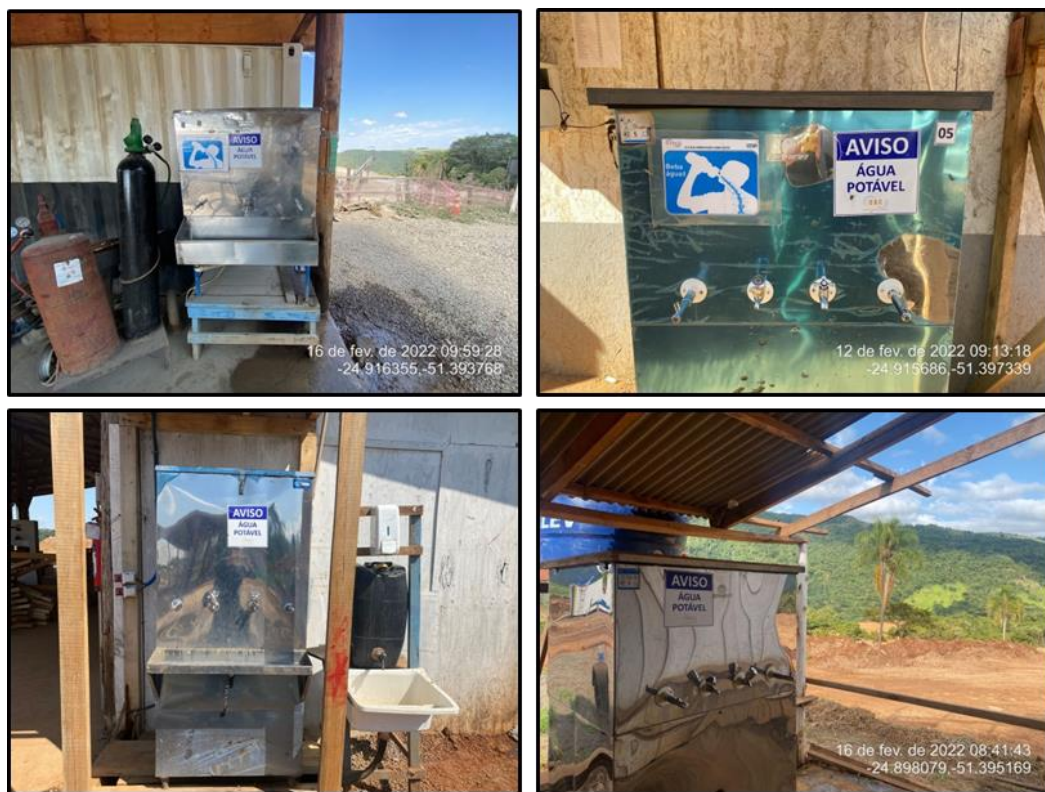
Figura 129 - Bebedouros com água potável nas áreas da PCH Confluência.
