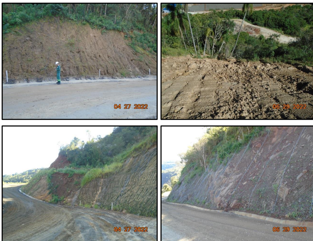
Figura 7 - Processos erosivos registrados no talude de aterro da via de acesso ao barramento. Vistoria realizada em 27/04/2022 e em 29/06/2022.
