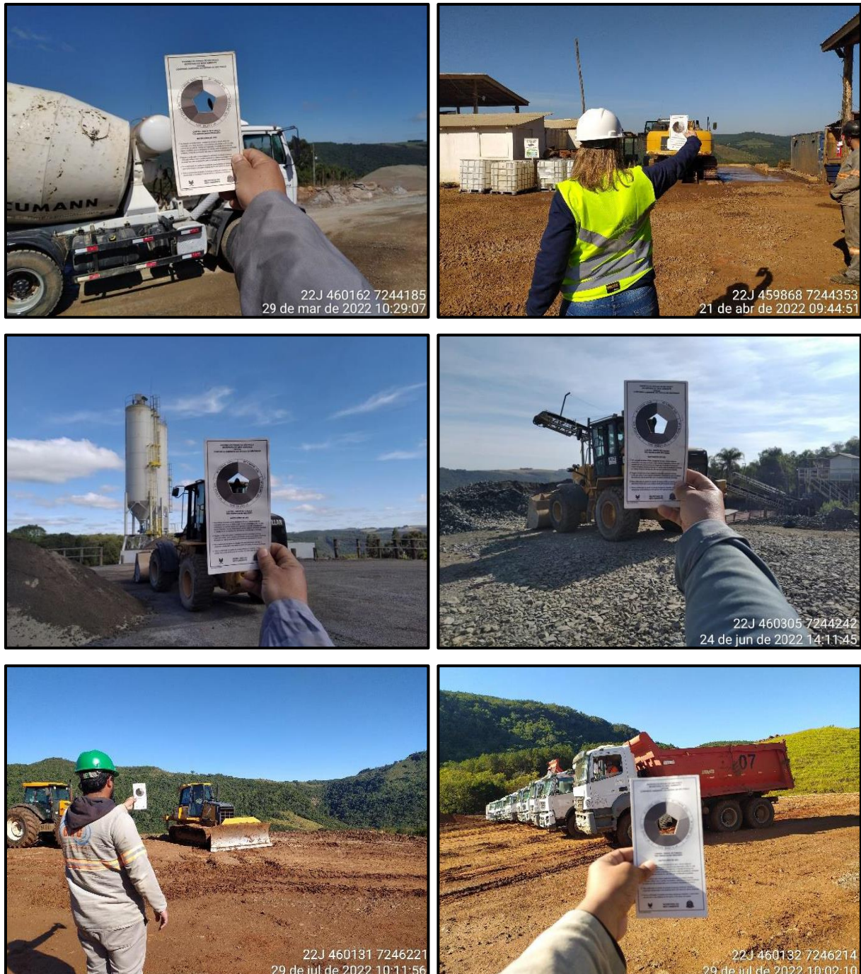
Figura 185 - Execução do teste de fumaça preta utilizando a escala Ringelmann durante o 3º semestre de implantação da PCH Confluência.
